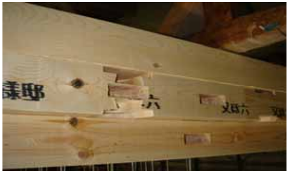
在来工法、柱・梁取付け仕口、梁断面欠損部分
